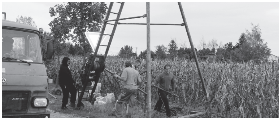
Výbudovanie monitorovacieho systému
